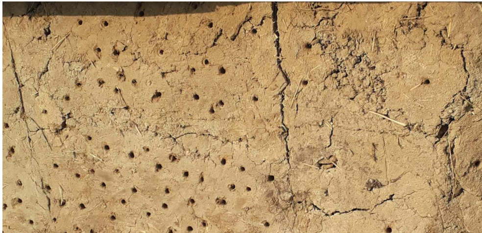
Abbildung 5: Risse in der Lehmwand.
